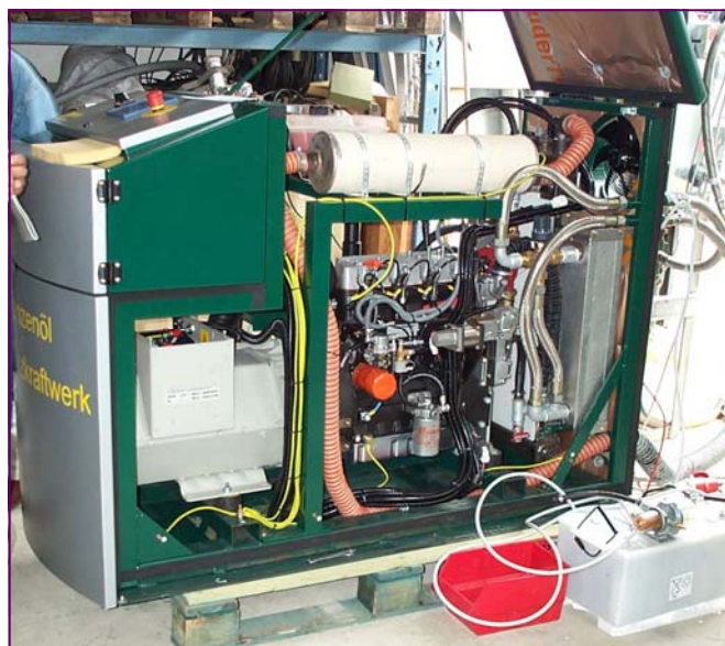
Foto 5 – Piccolo cogeneratore di 16 kWe + 20 kWt adattato all'uso del PVO.
